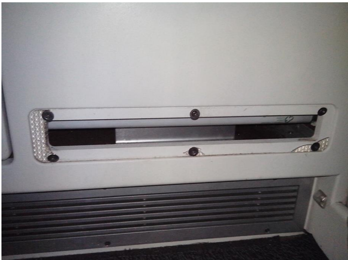
Figura 2 - Grelha de Ventilação e Lâmpada
