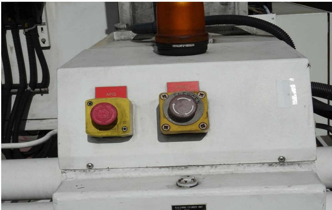
Figura 9 - Botão de emergência || Figure 9 - Emergency button
